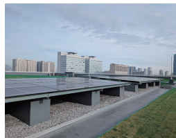
《太陽光パネル》 屋上でクリーン発電
