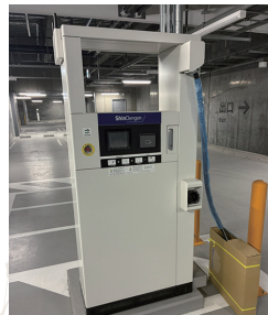
《EV充電器》 EV利用をサポート一部急速充電も
